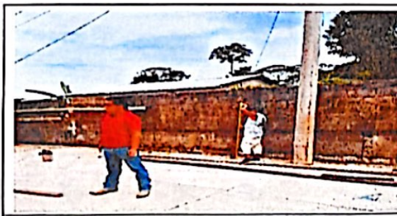
Foto 5: antes de antes del mantenimiento del muro y repello
